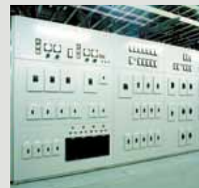
●コンピュータールーム
