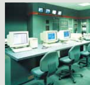
●コントロールルーム
