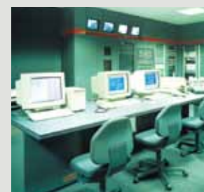
●コントロールルーム
